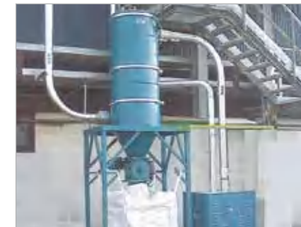
中央气泵 Central air pump
